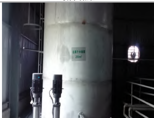
去离子水储罐
