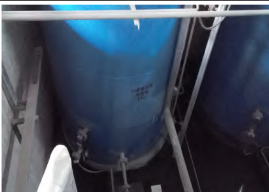
尿素溶液制备罐
