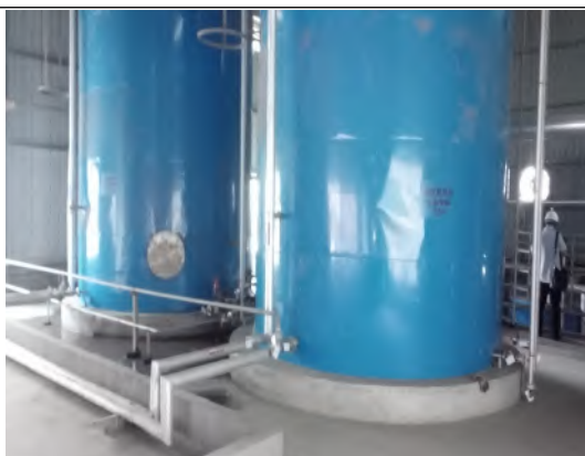
尿素溶液储罐
